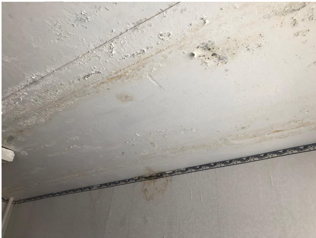
Фото 7. Следы протечек кровли на 2 этаже
