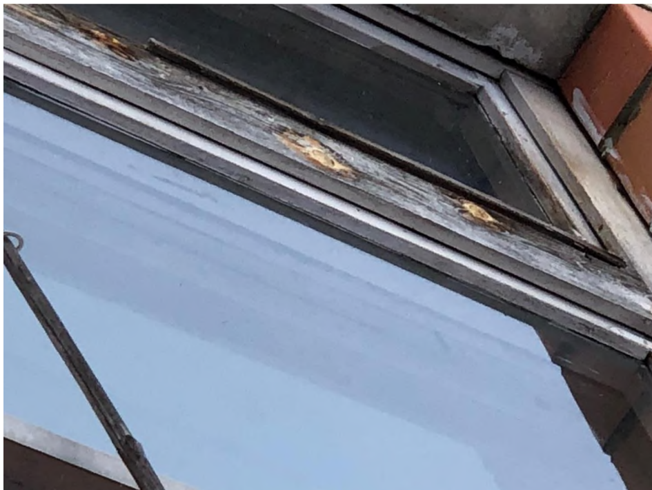
Фото 6. Коробление и рассыхание оконных блоков
